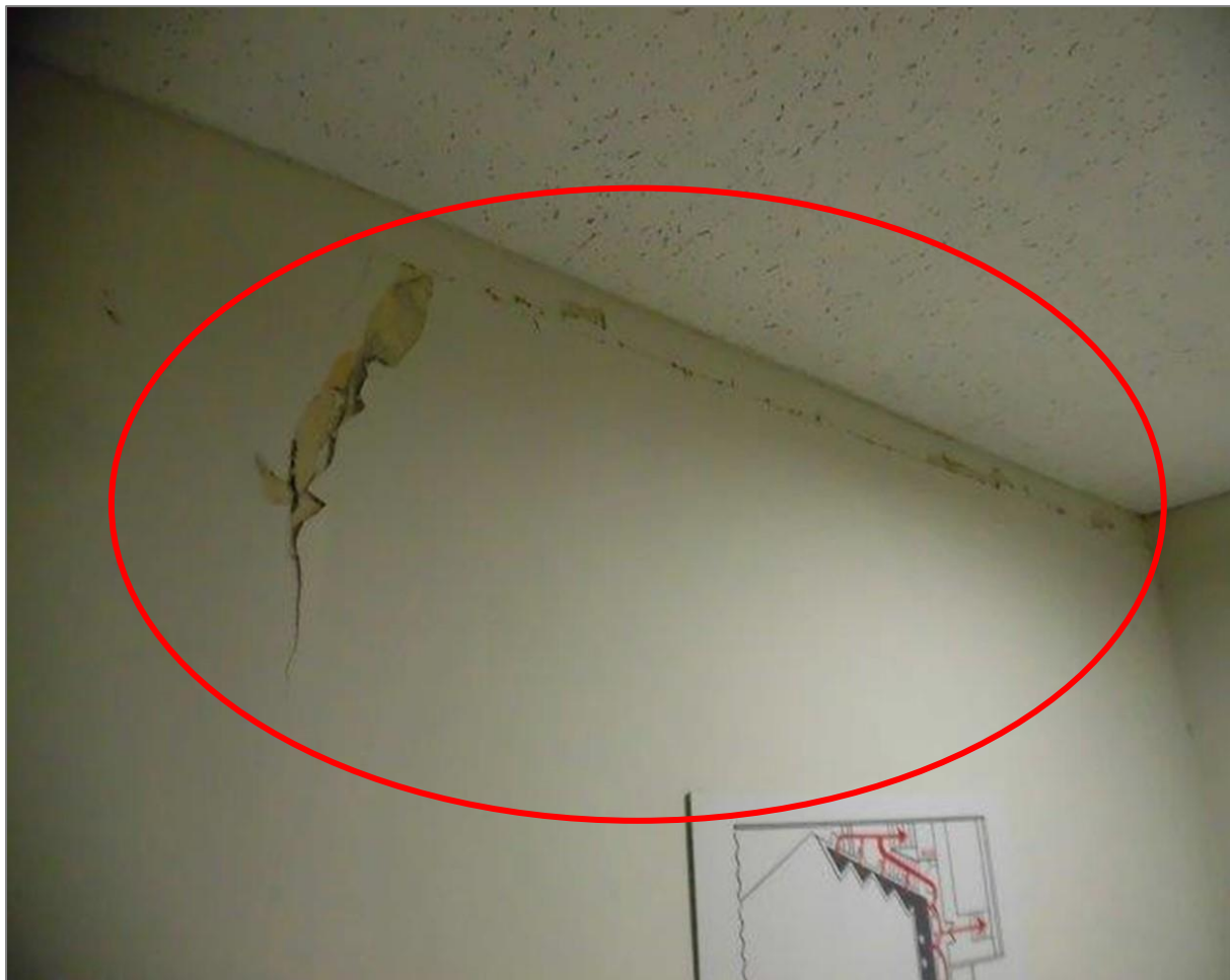
3階ロビー壁面のひび割れ
