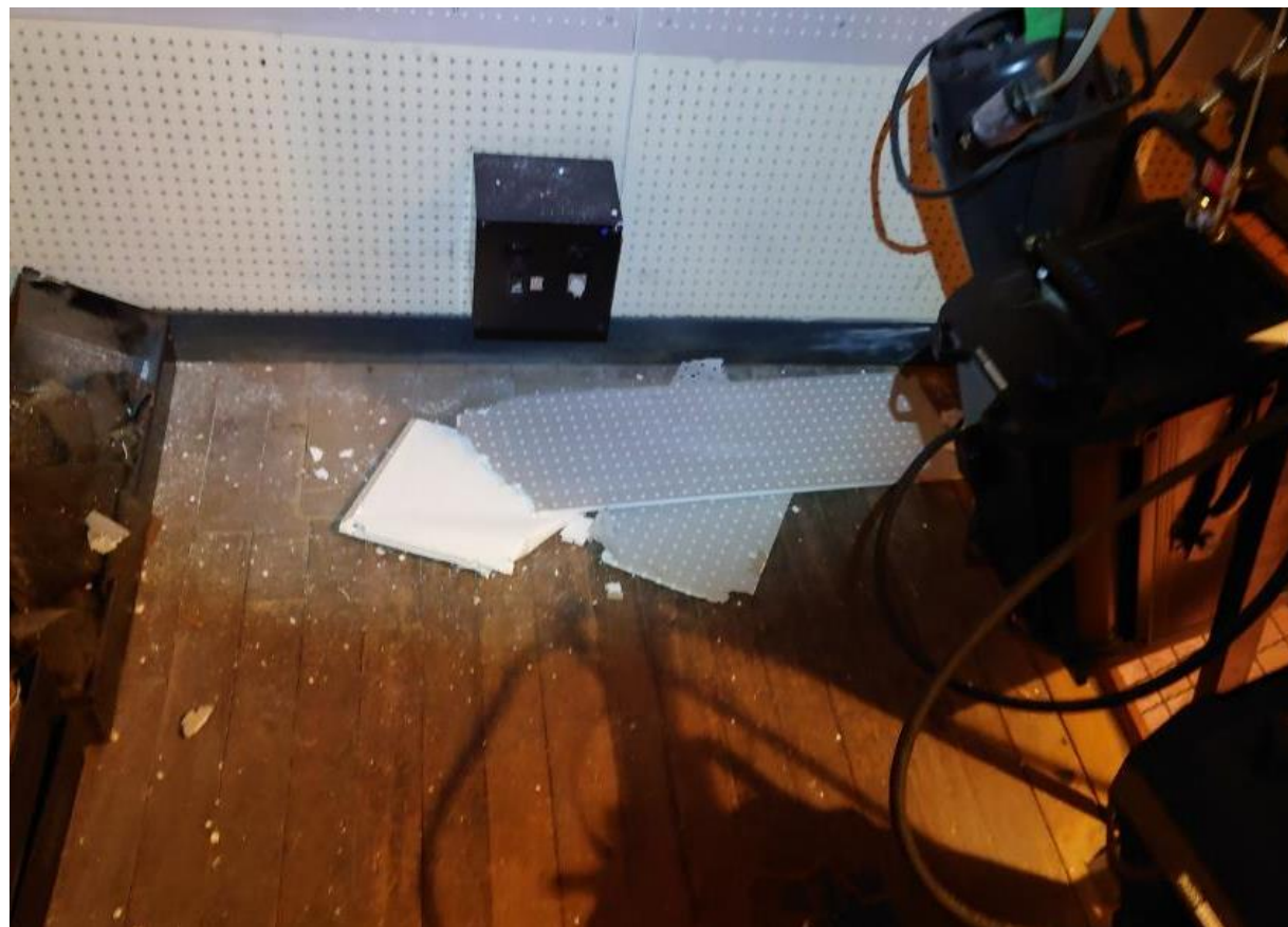
機材室壁面の崩落
