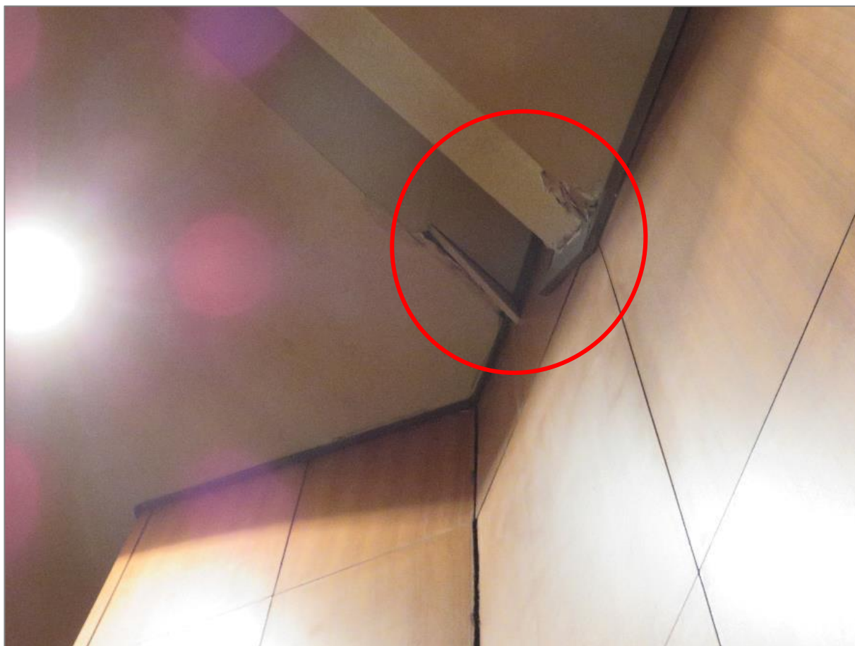
天井材の損傷
